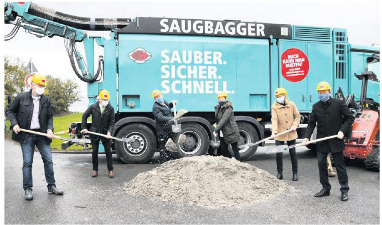
Symbolischer Spatenstich: Mit der Breitbandversorgung von 30 Haushalten in Brombach und Leberbach kann nunmehr begonnen werden. Unser Bild zeigt Bürgermeister Volker Oehlschläger und die Beteiligten des Eigenbetriebes, des Maschinenrings und der ausführenden Firma.
